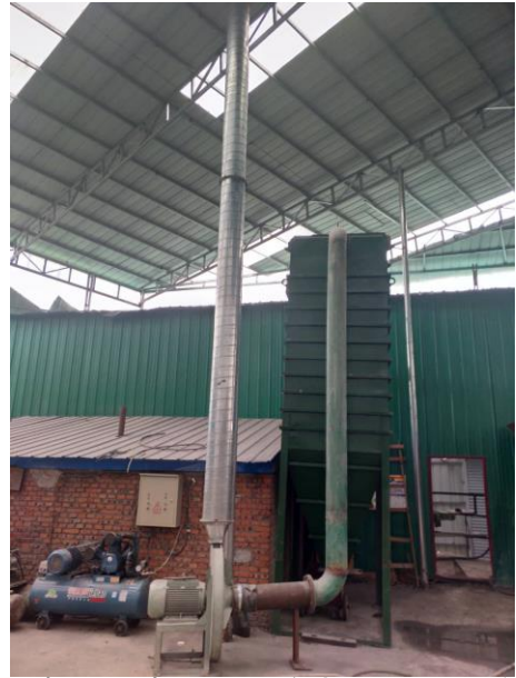
一破、二破共用袋除尘+15m 高排气筒
