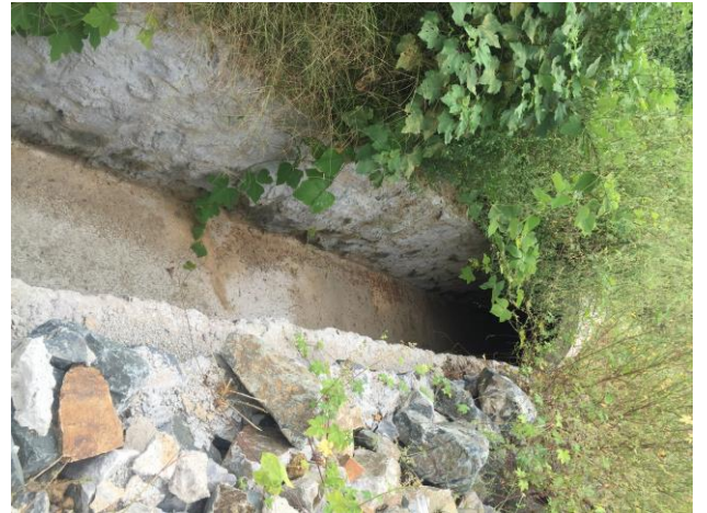
尾矿库排洪涵管
