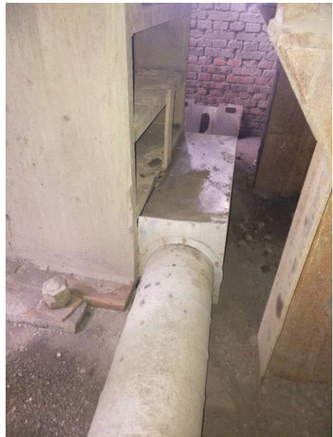
一破入口集气罩+集气管道
