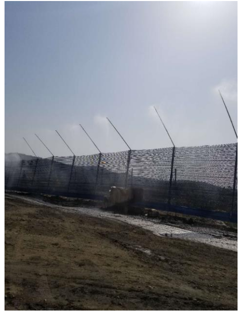
厂界水雾喷淋降尘
