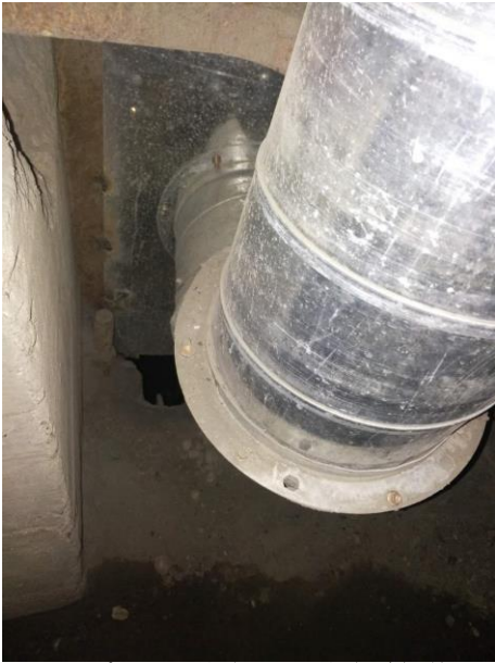
二破入口集气罩+集气管道
