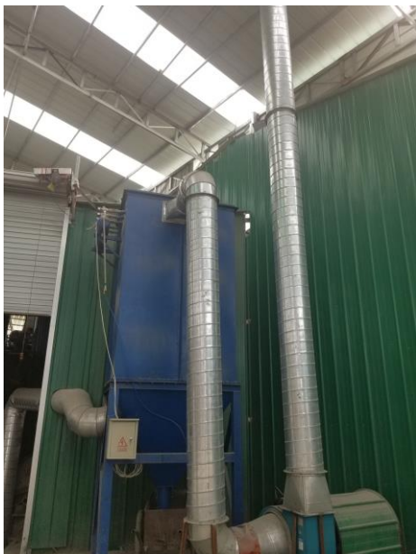
筛分、三破共用袋除尘+15m 排气筒
