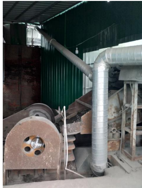
三破集气罩+集气管道
